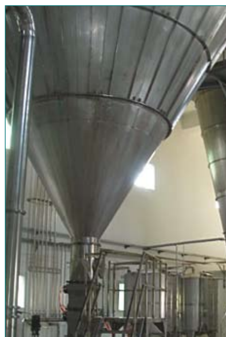
Конусная часть сушильной камеры распылительной сушилки AMDR-1500 с производительностью 1500 кг/ч по испаренной влаге.
